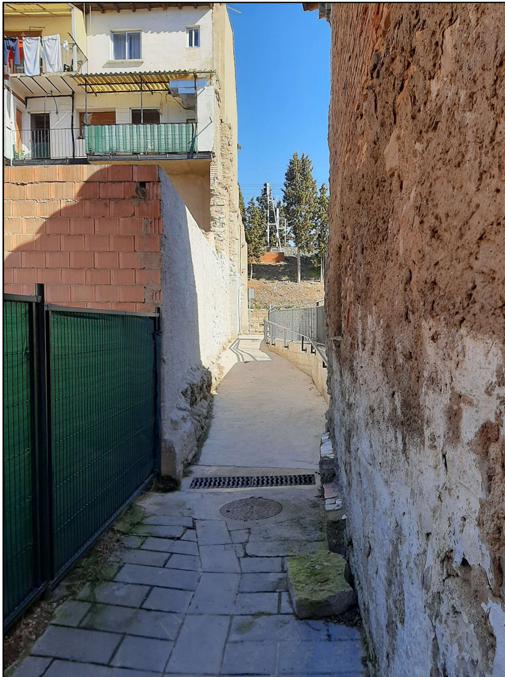
Ilustración 41. Alcantarilla, en la calle Huerto del Rey, con salida a la calle terraplén, por la que se inicia la inundación del casco viejo de Tudela por crecida del Ebro.
