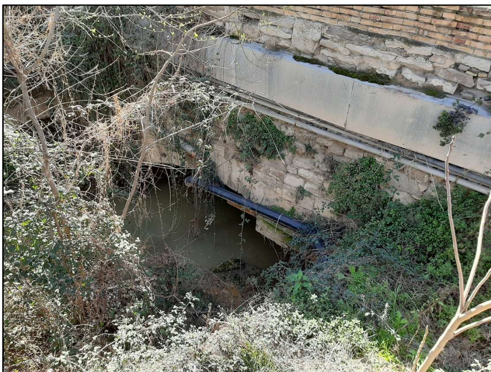
Ilustración 46. Vistas de la compuerta que regula la salida del caudal del barranco Mediavilla al cauce del Ebro. En este punto, al igual que en la salida del Queiles, se ha instalado una compuerta flotante, que se levanta al crecer el caudal del Ebro, evitando el retorno de estas aguas hacia las calles del casco viejo.
